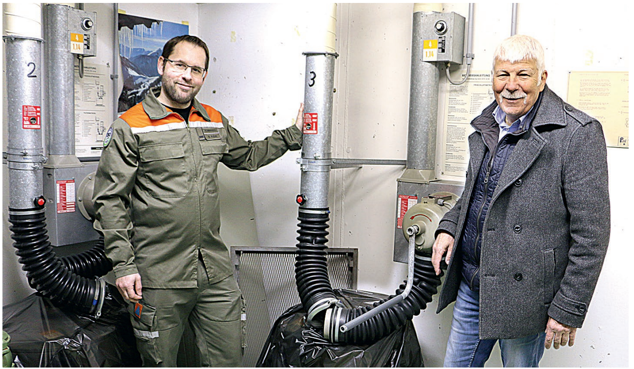
Mike Rudin und Mäni Moser bei der Lüftung der Zivilschutzanlage unter dem Döttinger Altersheim. Bei einem Stromausfall könnten die Geräte auch von Hand mit einer Kurbel betrieben werden.
